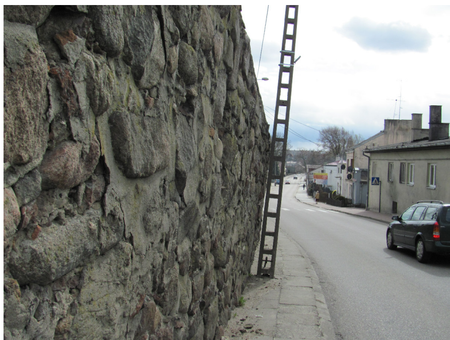
Fot.2 Wygięty mur oporowy wraz ze słupem przy ul. Wojska Polskiego.
