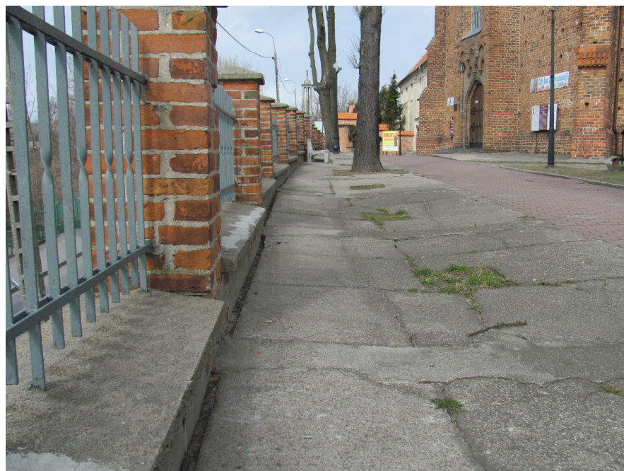
Fot.1 Szczelina w chodniku doprowadzającym do kościoła przy ul. Wojska Polskiego.
